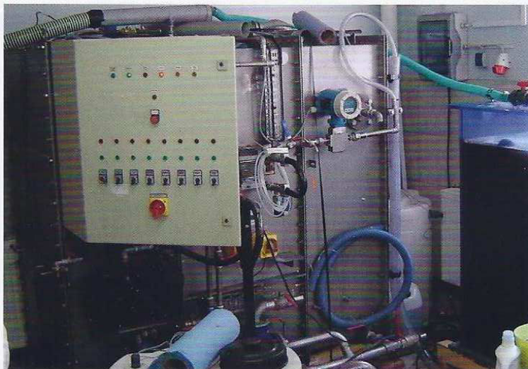
Die Anlage mit Membranbioreaktor in der Wäscherei.
